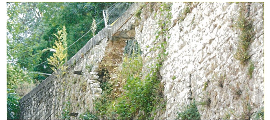
Il viadotto di Via Roma è in molte parti pericolante
