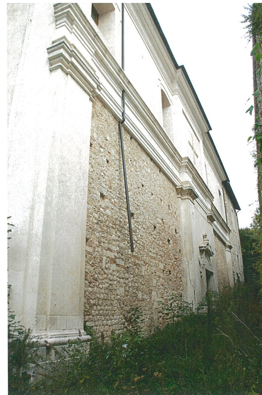
Il fronte principale della Chiesa di Santa Croce nel budello in cui è ridotto da circa due secoli per via del terrapieno di Via Roma
