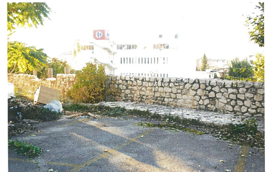
Il muraglione di contenimento degli antichi orti di Santa Croce visto dal piazzale asfaltato che lo sormonta
