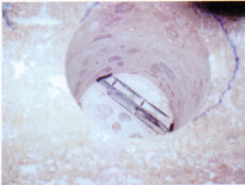
Trave T1: Armatura incontrata nel foro della carota
