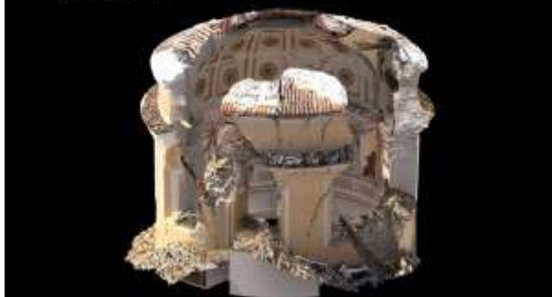
FASI DI MESSA IN SICUREZZA Stato di crollo post sisma
